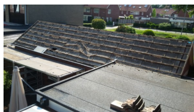
Situation vor der Asbestsanierung
